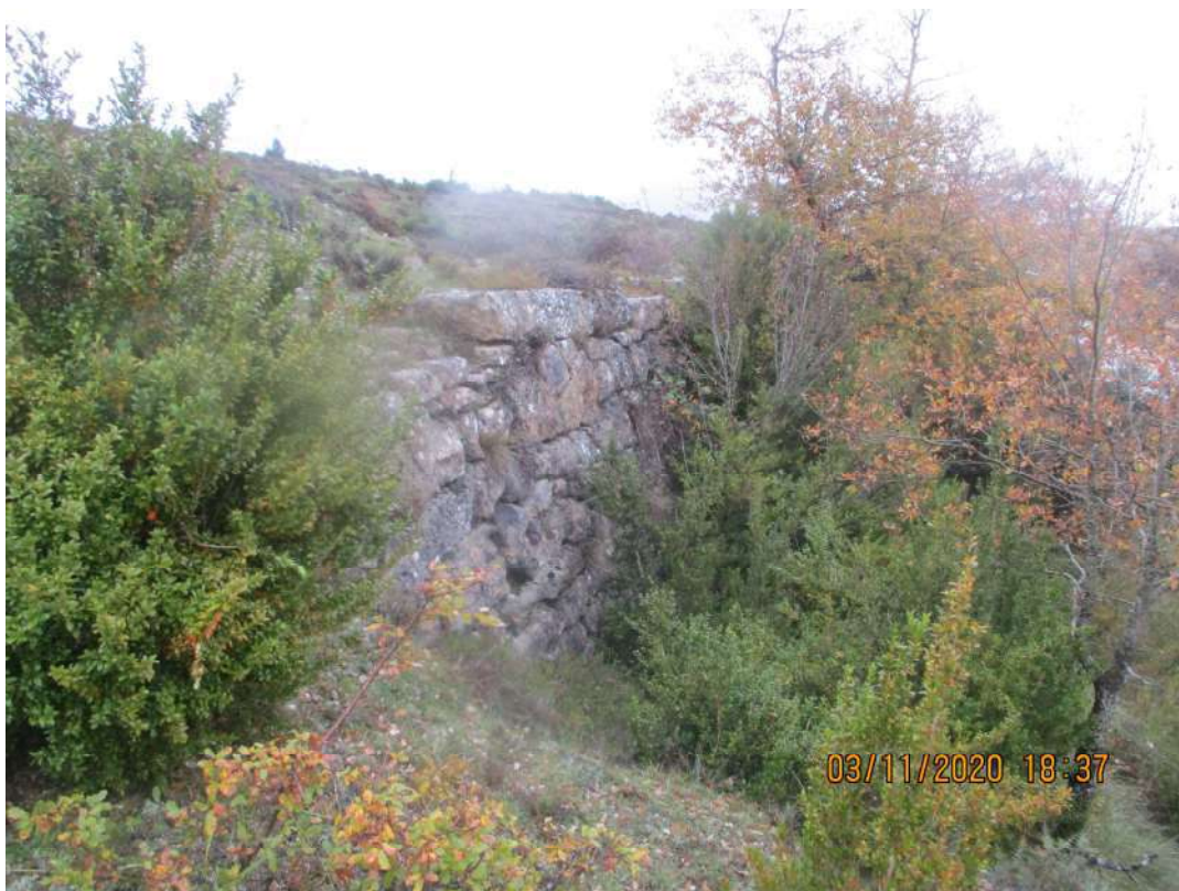
RESTOS DE MURO DE SOSTENIMIENTO DE LA CALZADA (VISTO DESDE EL PIE)
