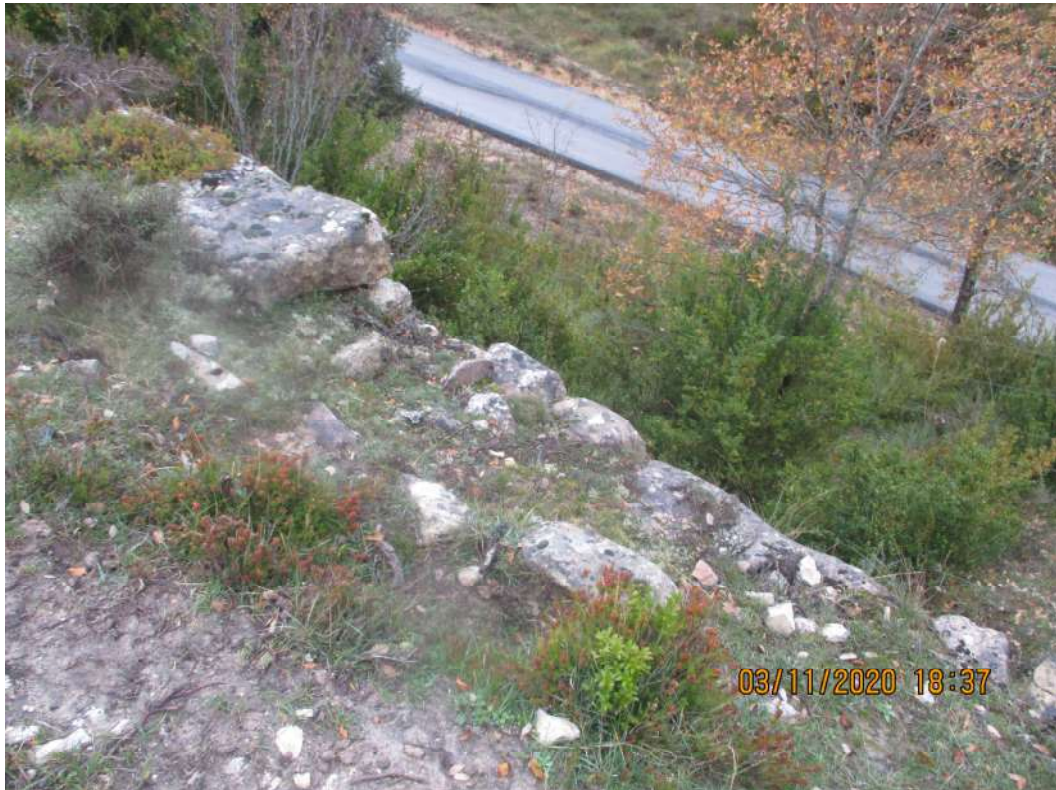
RESTOS DE MURO DE SOSTENIMIENTO DE LA CALZADA (VISTO DESDE ARRIBA)
